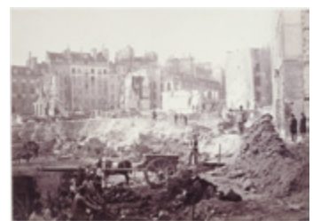
Charles Marville Percement de l'avenue de l'Opéra : Chantier de la Butte des Moulins du passage Molière , 1876-1877
